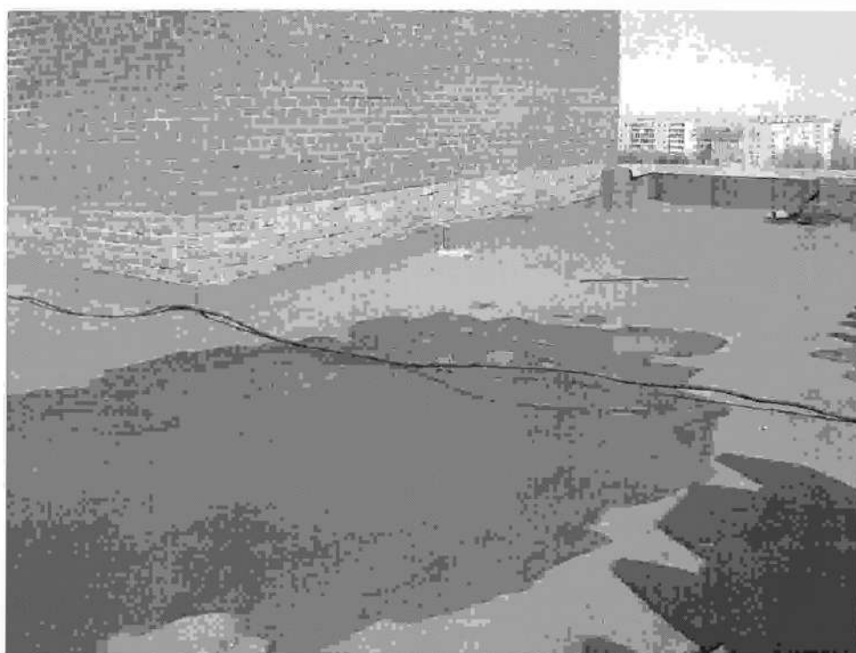
Фото 53. Уклон кровли не к воронке. Секция 11. Состояние на 01.04.2015г
