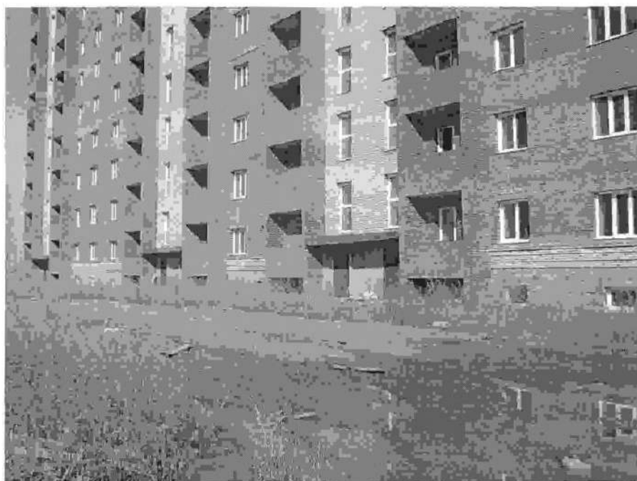
Фото 4. Главный фасад, Отсутствие тамбура. Секция 1, 2, 3. Состояние на 01.04.2015г.
