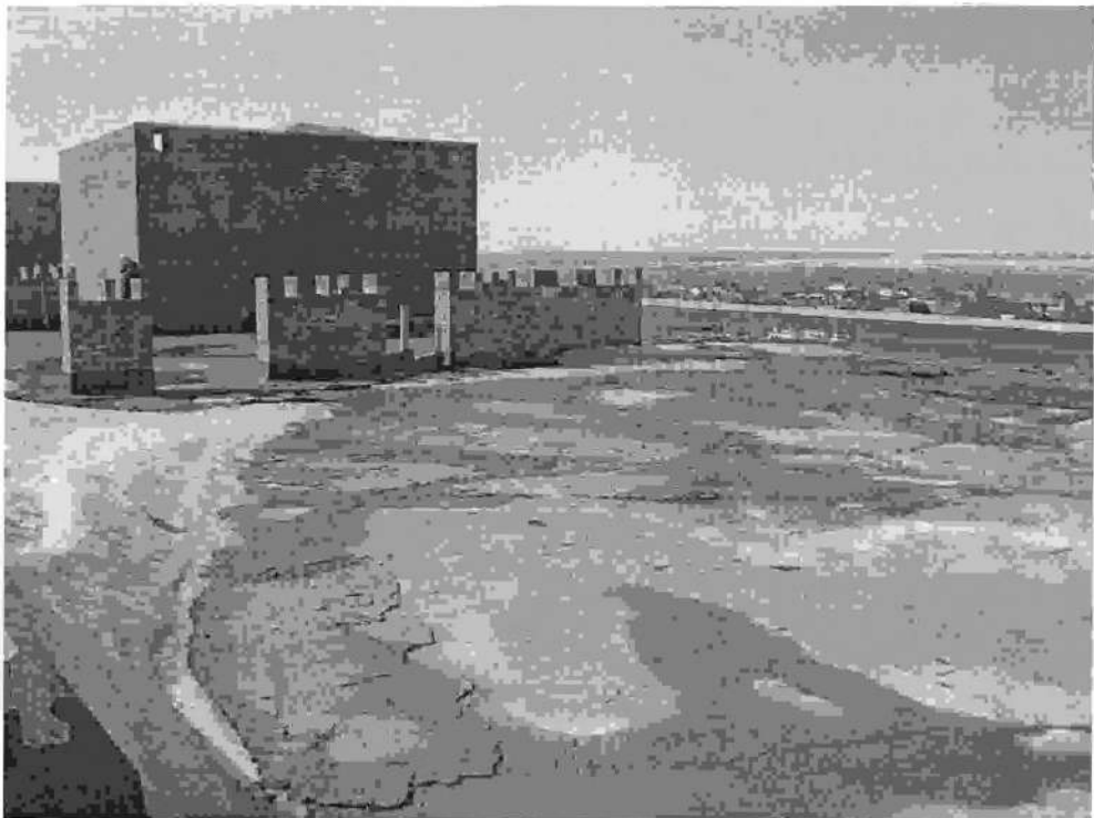
Фото 56. Отсутствует кровельное покрытие. Секция 6 . Состояние на 01.04.2015г
