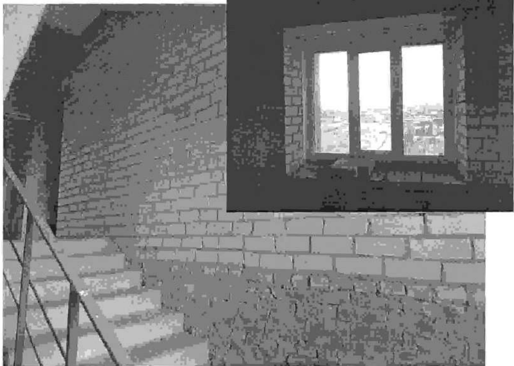
Фото 26. Наружные и внутренние стены. 9 секция. Состояние на 01.04.2015г.
