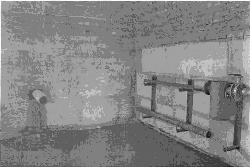
Фото 7. Подвал, секция 7. Водомерная рамка, ввод. Состояние на 02.04.2015г.
