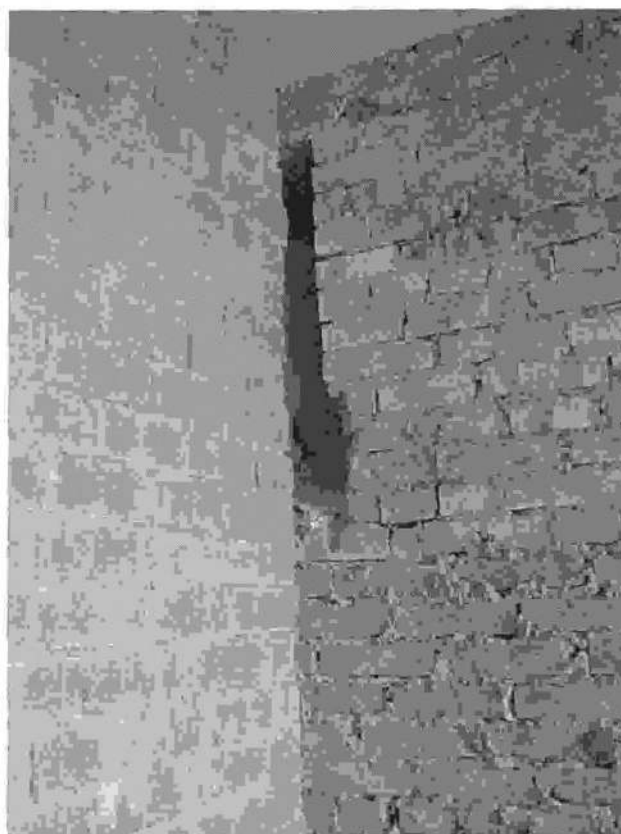
Фото 18. Отверстие вентиляционной шахты, секция 5. Состояние на 01.04.2015г.
